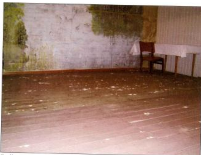
Podłoga sceny niszczona przez korniki.
