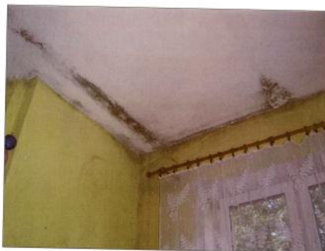
Zagrzybiony sufit świetlicy.
